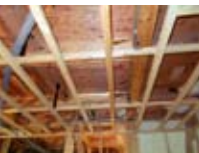
防振吊り金物を使用
